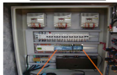
Quadro de Comando.
